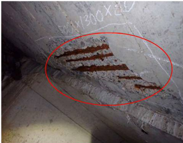
コンクリートの劣化（一宮井筋）
